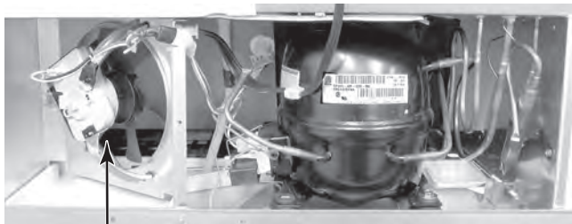
Condenser Fan Motor
